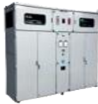
DC Substation Rectifiers
